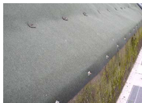
【端部処理を行った状態 (コンクリートアンカーピンによる固定)】
