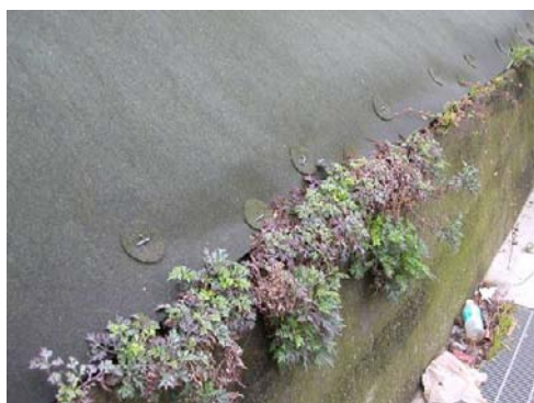
【端部処理をしていない状態】
